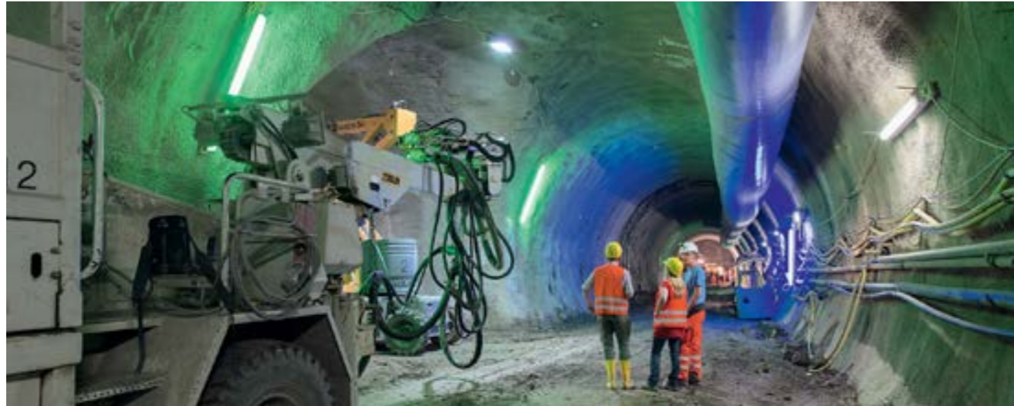
Der Stadtbahntunnel Heilbronner Straße ist eine sogenannte Folgemaßnahme von Stuttgart 21. Das Projekt ist aufgrund seiner innerstädtischen Lage technisch sehr komplex und anspruchsvoll.
